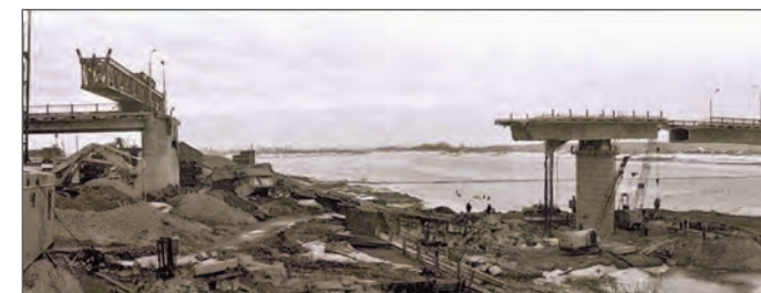
Обрушение пролета моста через реку Сухону в Великом Устюге, 1986 год
